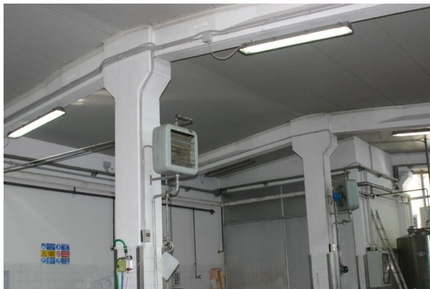
Figura 31: Impianto di aerazione all'interno del caseificio
